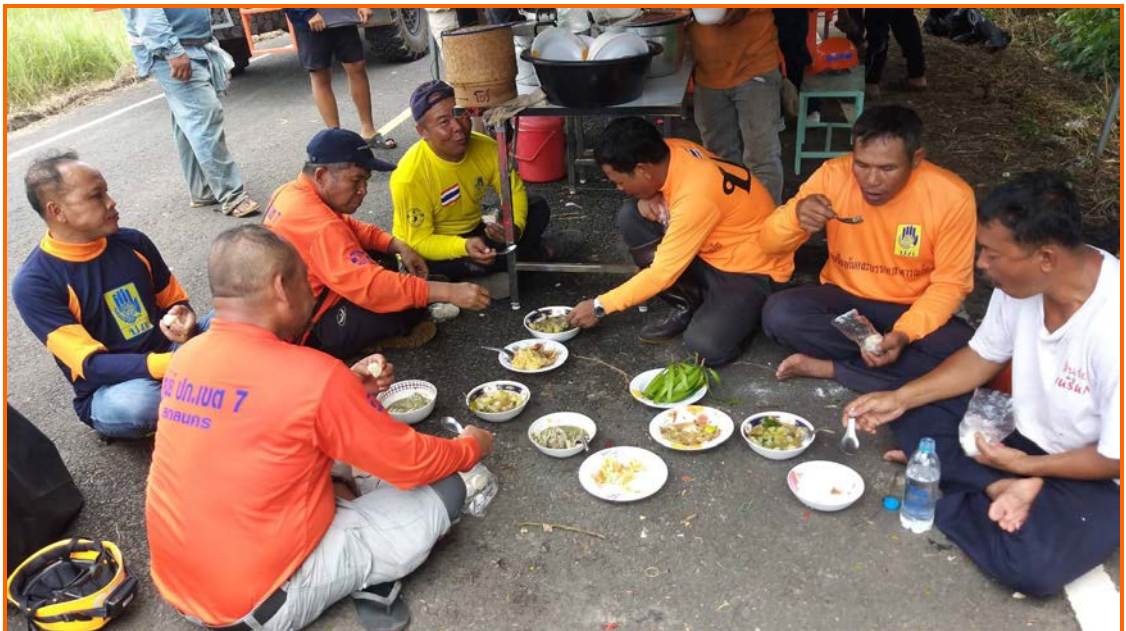
ชาวบ้านบริเวณใกล้เคียง นำอาหารมาให้เจ้าหน้าที่และจิตอาสาชุดติดตั้งสะพานแบลีย์บริเวณถนนสายบ้านนายอ - บ้านป่าพยอม ตำบลเหล่าหมี อำเภอดอนตาล จังหวัดมุกดาหาร ระหว่างวันที่ ๒ - ๘ กันยายน ๒๕๖๒ ตลอดระยะเวลาการดำเนินการ
